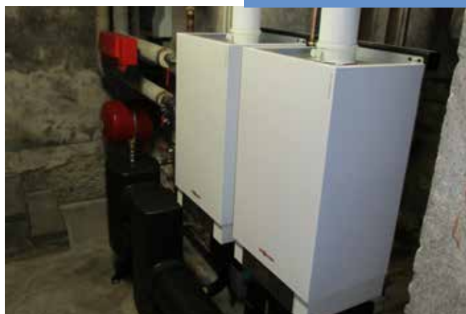
Des économies d'énergie en perspective grâce à l'installation d'une nouvelle chaufferie.
